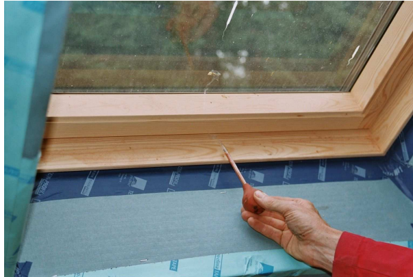
De rookproef: een heel eenvoudige methode om kieren en spleten op te sporen: de rook zal er op die plaatsen naar buiten gezogen worden. .
